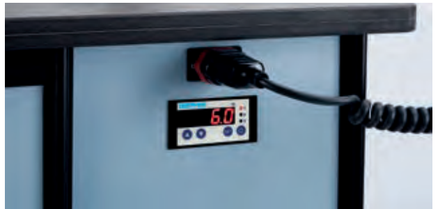
Netzanschluss und Steuerung zur Kontrolle des Betriebszustands
